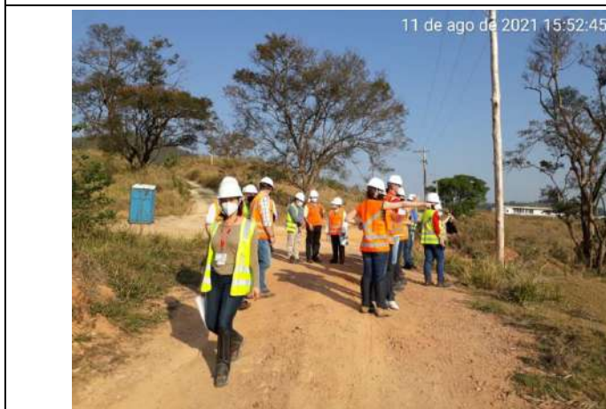
Foto 7 – Representantes e convidados durante visita à obra do empreendimento Barragem Pedreira. Data: (11/08/2021)
